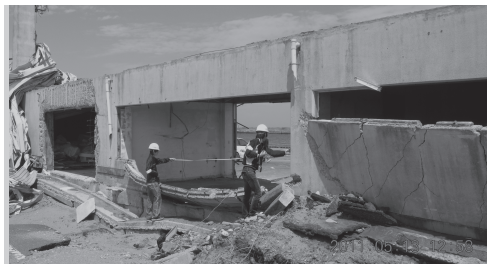
閑上漁港では、津波の水圧で市場の RC 造の壁が面外方向へ倒壊した。近くには放射状のひび割れをした壁もあり、計り知れない水圧を想定させた
